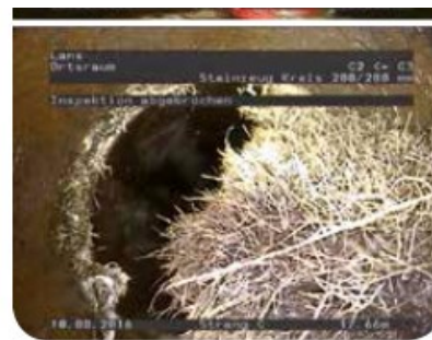
Schadensbilder aus dem LIS - Das Kanalnetz wird nun laufend saniert..
